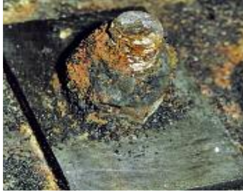
Figure 14 : Corrosion galvanique des fixations en inox d'un bassin de filtrage d'une installation de traitement de l'eau, impliquant des charbons actifs : assemblage (à gauche) et corps de boulon en nuance 1.4016, montrant une perte de section due à la corrosion (à droite)
